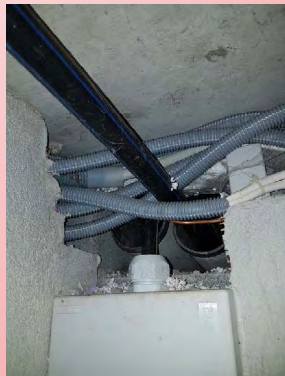
Présence de points d'infiltration du radon dans le bâtiment
