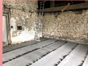
Pose d'une membrane pare-radon sans assurer l'étanchéité des plinthes à la jonction mur / dalle
