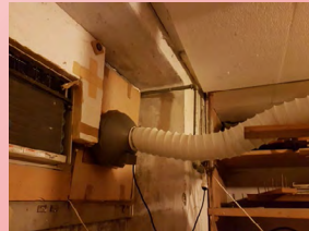
Pertes de charges dans le système de ventilation (courbes, condensation, etc)
