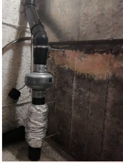
Tuyaux et ventilateurs non étanches
