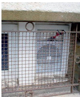
La cave (ou le vide sanitaire) est mise en dépression par rapport à la partie habitée au moyen d'un petit ventilateur.
