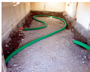
Rénovation de la structure sous le plancher : pose d'un système de drainage du radon
