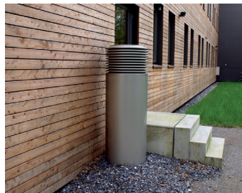
Prise d'air d'une installation mécanique d'apport d'air frais
