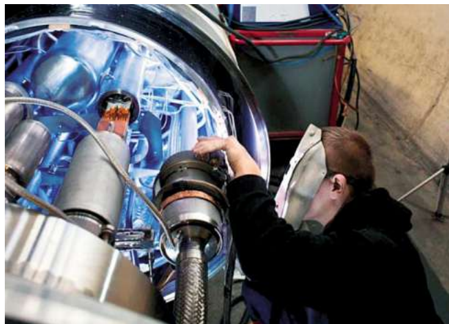
Abb. 5: Unterhalt von Verbindungen des kryogenischen Systems – eine der grossen Aufgaben während des langen Shutdowns 2013/2014 am CERN
