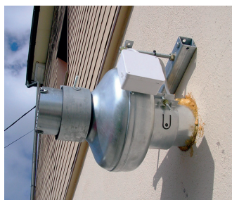
Un ventilatore situato all'esterno crea una leggera depressione sotto la soletta di fondazione.
