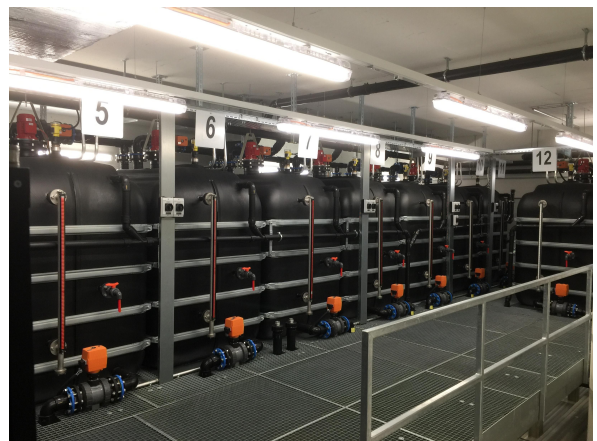
Beispiel einer Abwasserkontrollanlage. Foto: P. Koch
