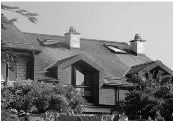
Ardesie per tetti in fibrocemento con amianto, foto: IST
