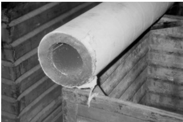
Isolazione di tubazioni contenente amianto, foto: IST
