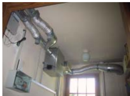
Figur 13 Ventilator und Steuerung in Nebenraum des Kindergartens
