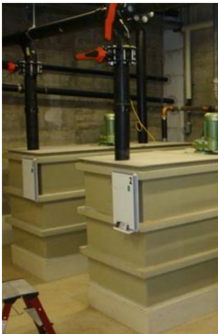
Fig.1: Réservoir collecteur des eaux usées
