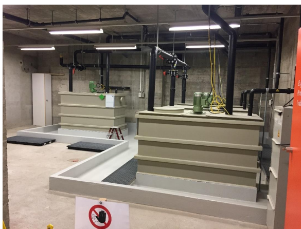
Abbildung 9: Abwasserkontrollanlage für Therapieziimmer
