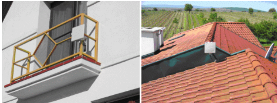
Abbildung 7 : WiMAX Sende-Empfangsanlagen an Hausfassaden oder Dächern. Quelle: 18
