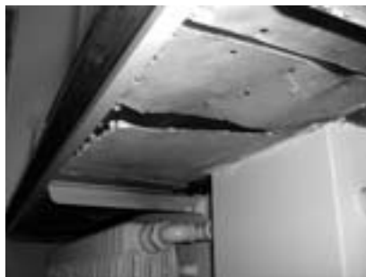
Carton d'amiante accessible fixé sous un appui de fenêtre
